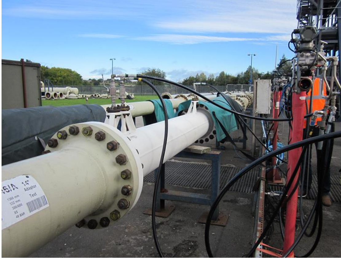
Fig. 11 - 14" Cone DP Meter Under Test
